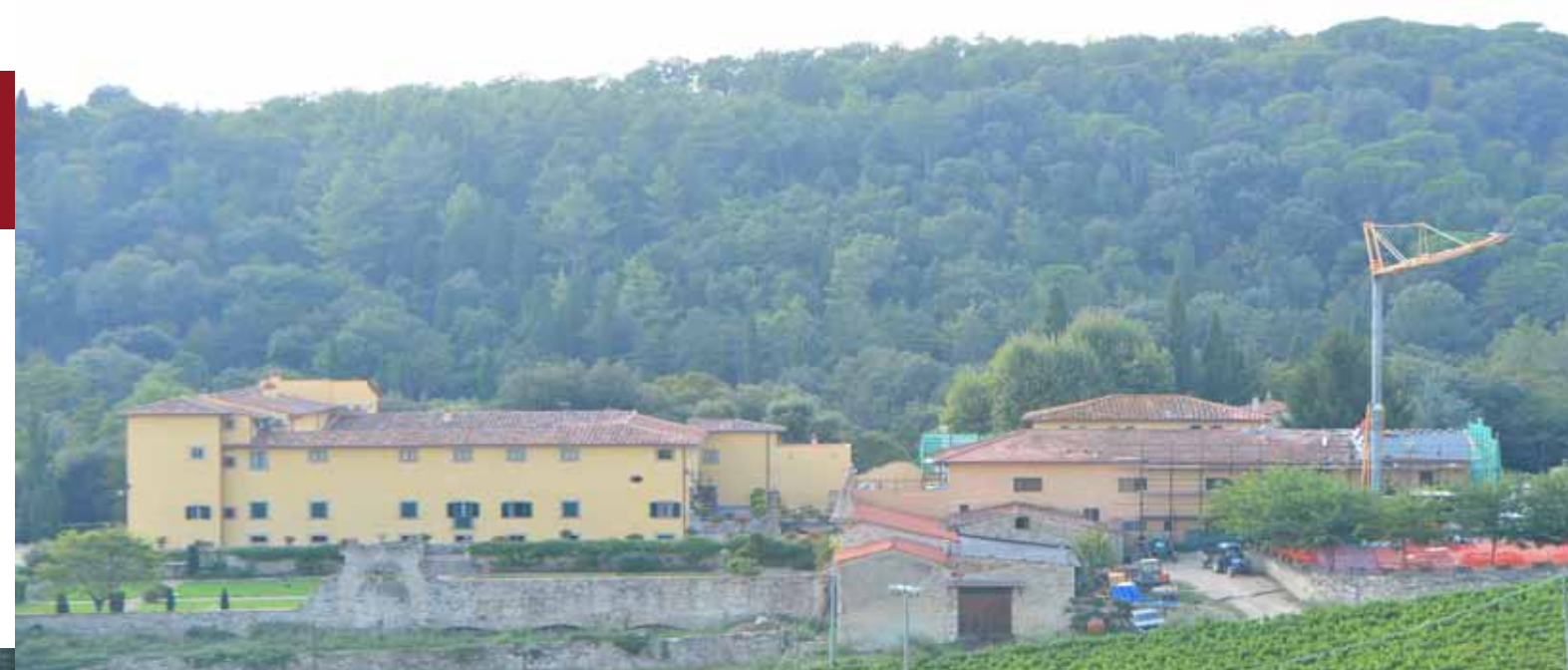
Vue d'ensemble du Séminaire : la Villa Martelli à gauche, rénovée en 2014-2015, et le bâtiment Sainte-Marie sur la droite, en cours de rénovation.
