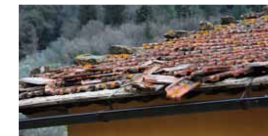
Tuiles du bâtiment Sainte-Marie en mars 2015
