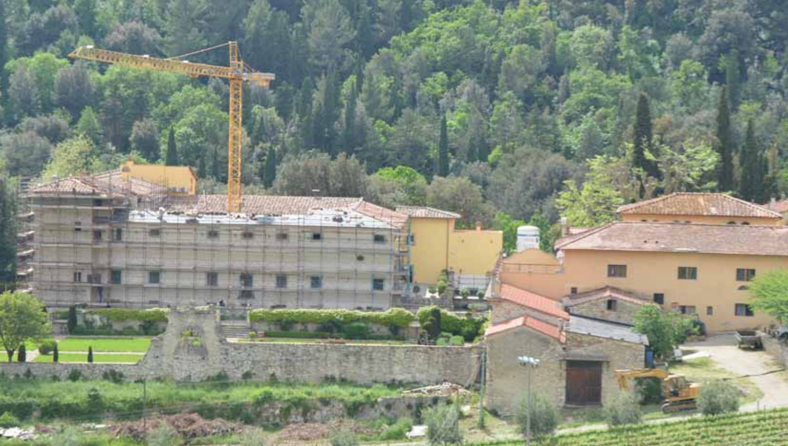
Gricigliano a maggio 2015: la maggior parte dei tetti della Villa è stata rifatta.
